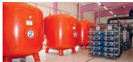
Vandens ruošykla: vandens nugeležinimo filtrai ir atbulinio osmoso įrenginiai
