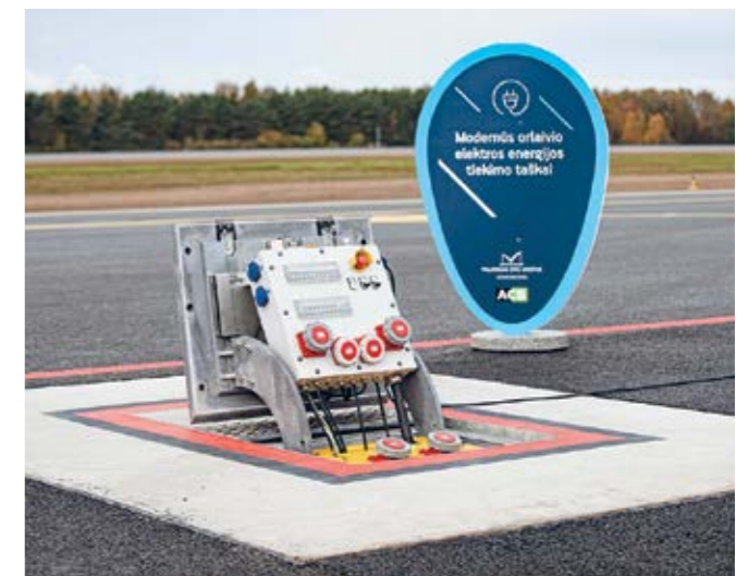
CO 2 emisijų mažinimo klausimas rekonstrukcijos metu išspręstas pačiame perone diegiant specializuotus orlaivių elektros maitinimo įrenginius (GPU) tam tikrose lėktuvų aikštelėse, po žeme.
